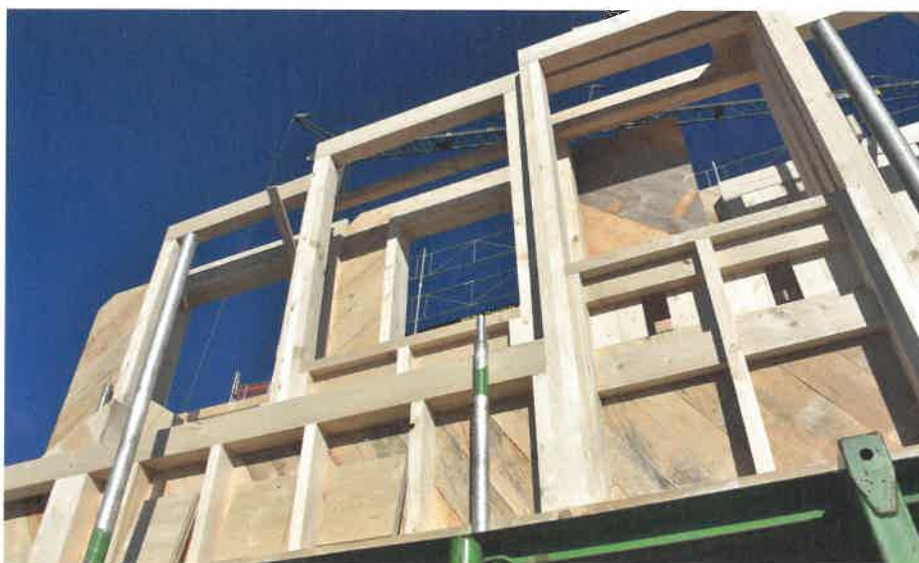
Die im Werk vorgefertigten Massivholzbauteile wurden grösstenteils aus Käferholz aus dem Siblinger Wald hergestellt.
