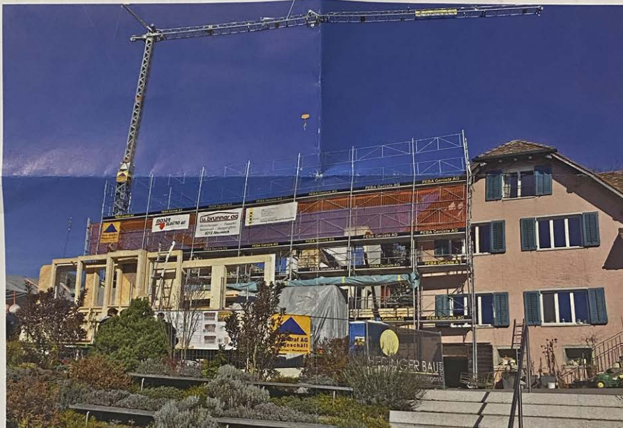
Auf dem Siblingler Randen entsteht zurzeit ein Holzbau mit Mehrzweckraum, Hofladen, öffentlicher Toilette und mit zwei Mietwohnungen.
